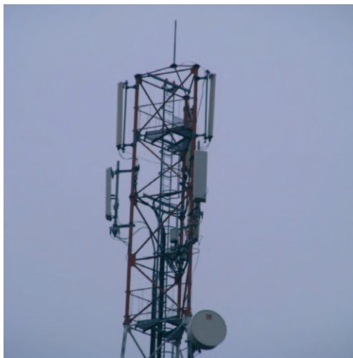
Fig. 5.10 Stație de bază ROMTELECOM
